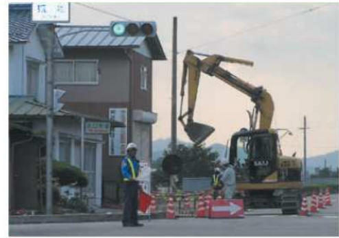
▶ 道路工事や災害時の緊急電源設備として
