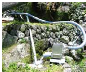
第9図：沢の水を活用した水力発電機
